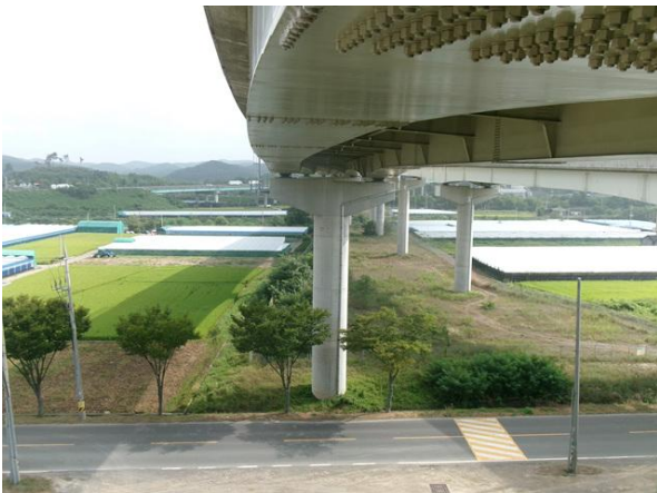
교각 P10 상태현황
