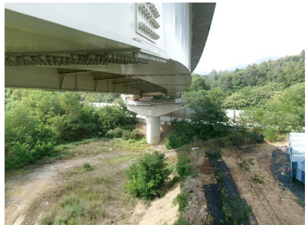
교각 P13 상태현황
